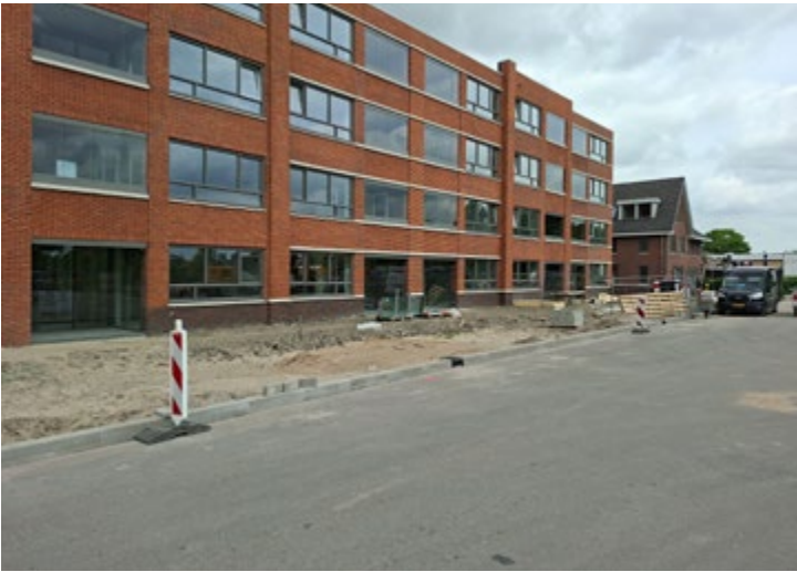
Op een markant punt langs de Samoaweg worden in juni/juli 24 appartementen en een twee-onder-een-kap woning opgeleverd.
