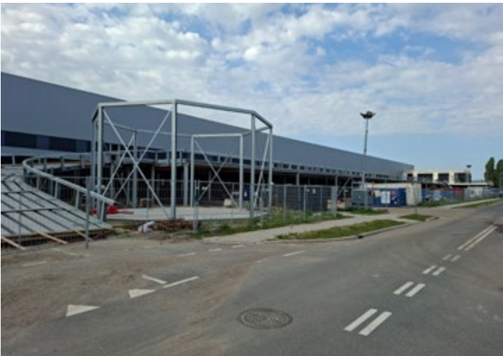
De bouw van het nieuwe bedrijfsgebouw voor TICA Aalsmeer is in volle gang door ontwikkelaar Next Level Development.
